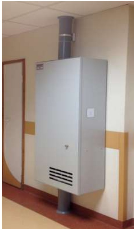
Stacja wandaloodporna na korytarzu
